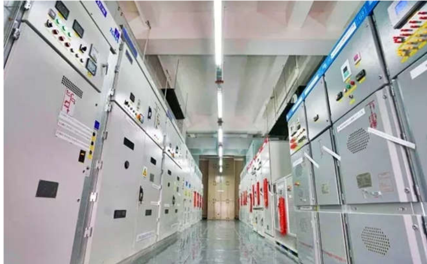
±10kV三端口直流断路器正常运行
