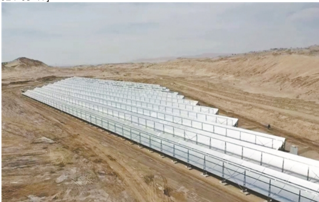
英东低碳排放示范区 (一期) 工程光热项目。张琦 摄
