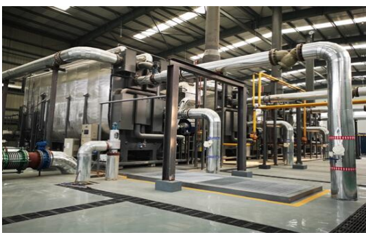
总装机容量4×65MW 补燃型大温差中继能源站
