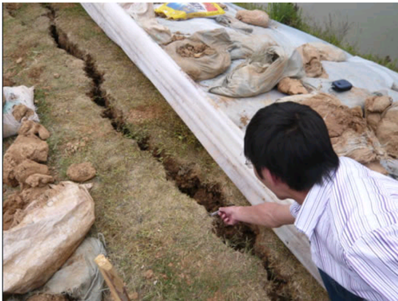
图1 地震导致的坝顶裂缝
