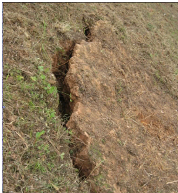
图2 地震导致的坝坡裂缝
