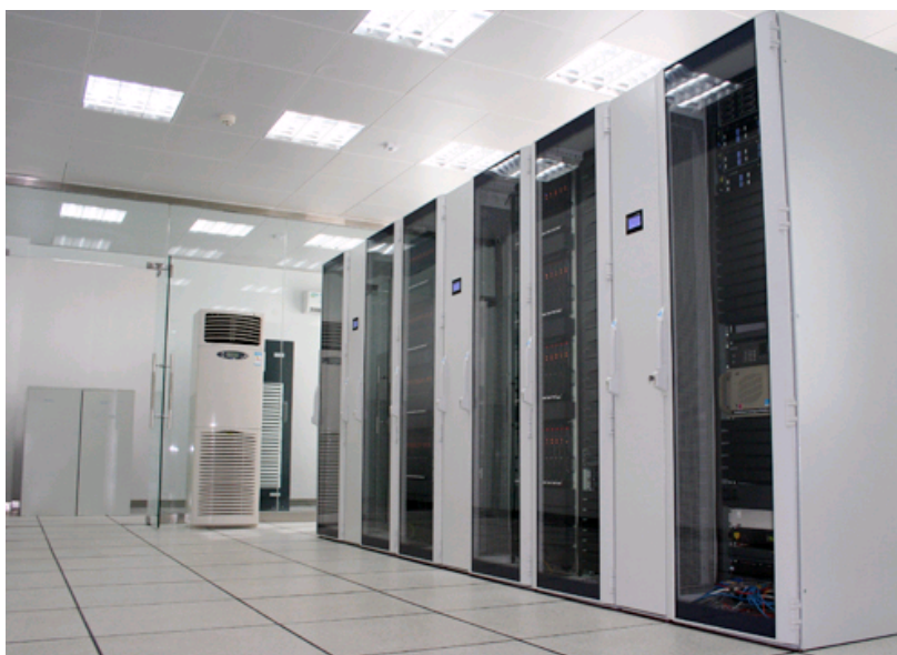
超算中心机房
