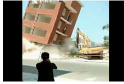
司机误判方向 挖机被楼体砸中
