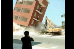
司机误判方向 挖机被楼体砸中
