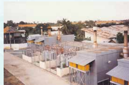
总装机容量10MW的柬埔寨C3电站工程
