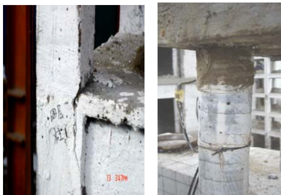
图 3 上部结构及支盘桩的裂缝情况
