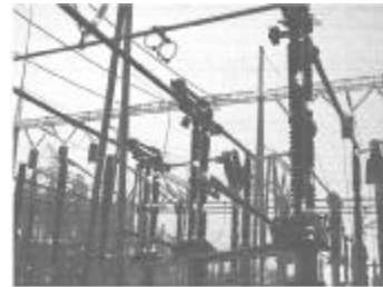
图 3 设备覆冰造成放电严重
