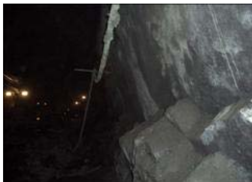
图 2 主厂房上游边墙的倾倒破坏
