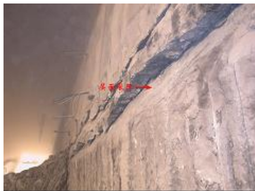
图 3 主厂房下游边墙沿层面裂隙张开塌落
