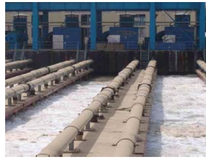
图 2 脱硫海水曝气池
