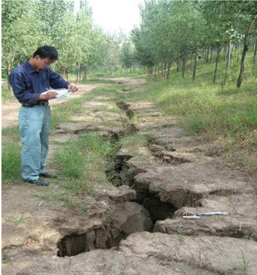
2005年5月5日中雨后，152+300处辅道被雨毁情况
