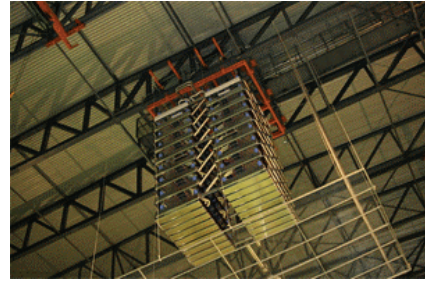
图 5 换流阀阀塔外观
