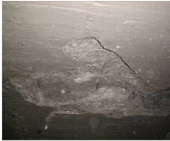
(a) 第1临界深度破坏情况
