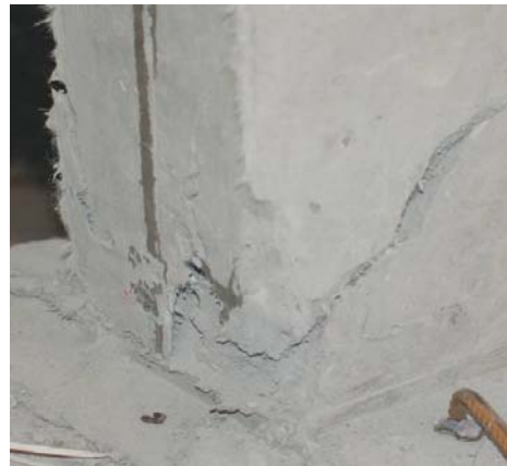
(b) 墙脚混凝土斜裂缝
