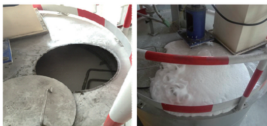
图2 聚合物分散装置的溶解罐起泡溢罐
