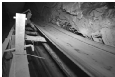
图 1 主运输大巷变形破坏情况
