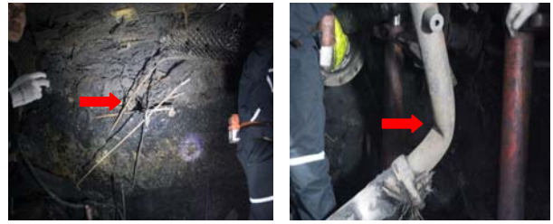
(a) 煤壁整体移动巷道合拢 (b) 支护弯曲
