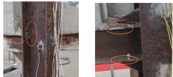
(a) 锈层脱落
