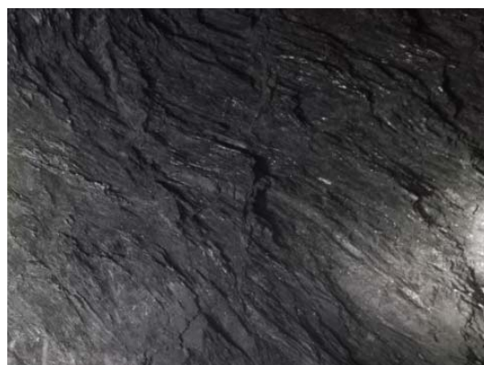
图 1 隧道揭露炭质板岩状况
